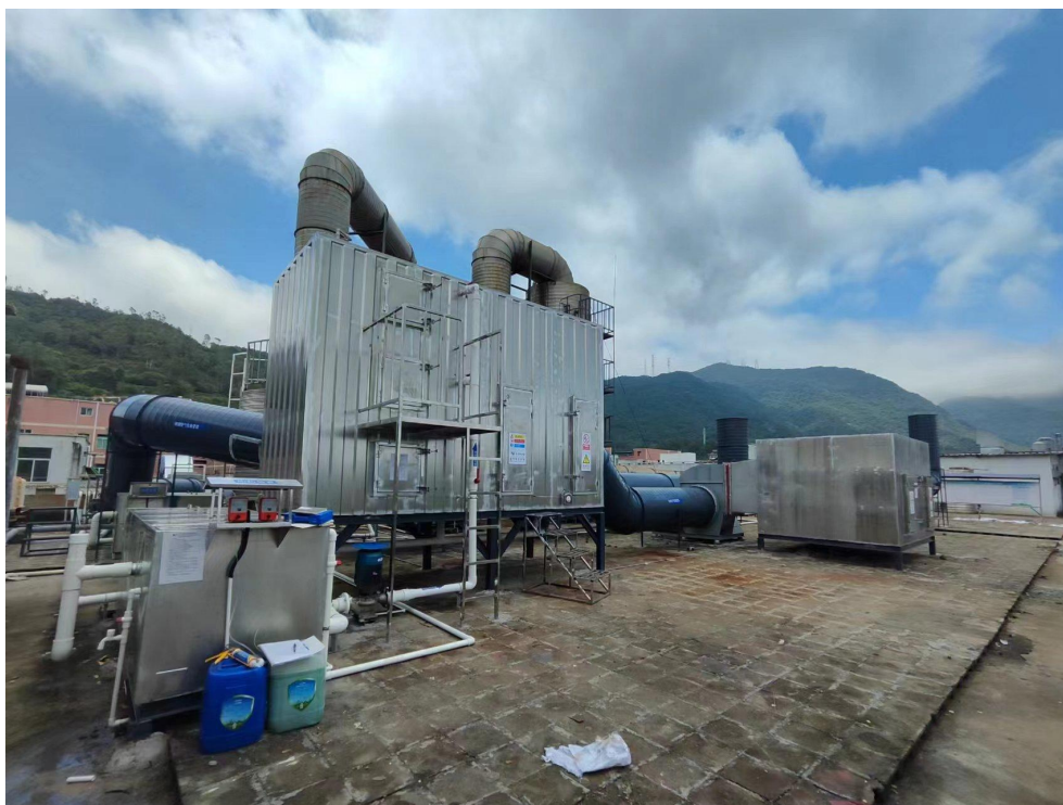
喷漆车间废气收集管道及净化设施
